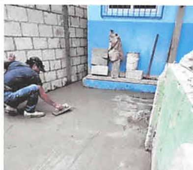
Foto 2: vista de la torta de cemento del frente de la cocina que necesita reparación.
