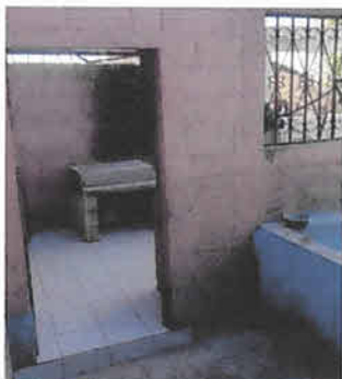
Foto 1: vista del frente de la cocina que necesita reparación.
