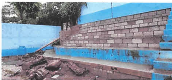
Foto 5: reparación de graderio en mal estado.
