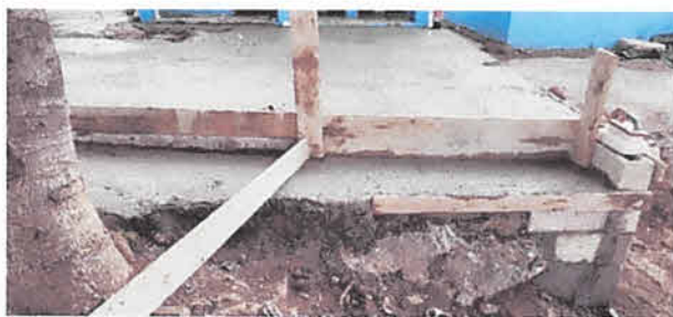
Foto 3: Vista de la torta del frente de los sanitarios que necesita reparación.
