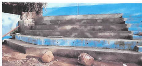
Foto 6: Vista del graderio en mal estado que necesita reparación.
